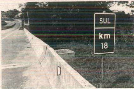
Vista sul da pista sentido litoral, com a caixa de contenção e o sistema de drenagem fechado.
