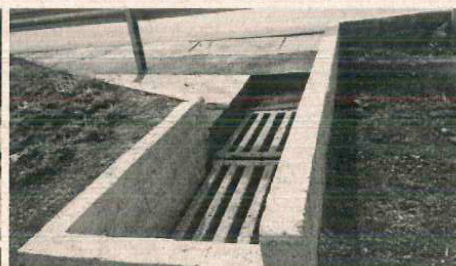
Detalhe da caixa de contenção de produtos perigosos.
