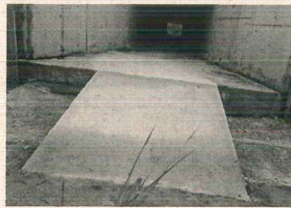
Detalhe da rampa de concreto implantada na saída do emboque da passagem de fauna.
