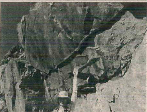
Foto 1.11. Executar medidas de estabilização de talude em rocha. Constatação de deslocamento dos blocos. Perigo de queda de blocos. (Km 32+900).
